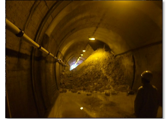
トンネル天井部崩落 (H23. 8. 21) 直後
